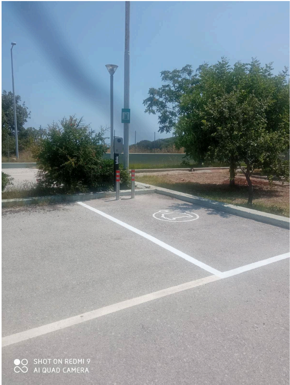
Σταθμός φόρτισης KEME
